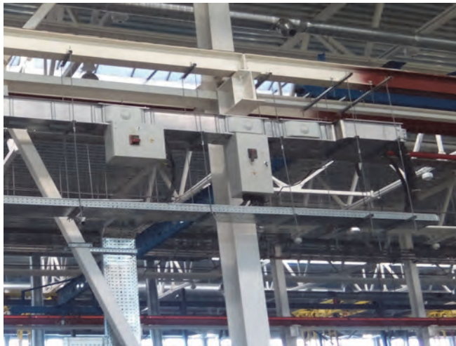
Коробка ответвительная вертикальная и горизонтальная с автоматическим выключателем и выносной ручкой на двери.
