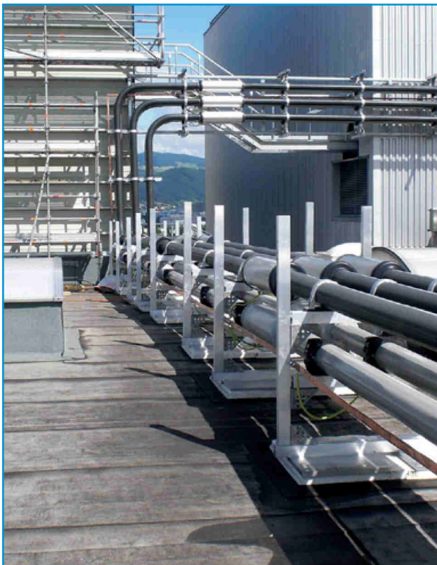
Austria - GUD Linz: 12kV - 4500A
