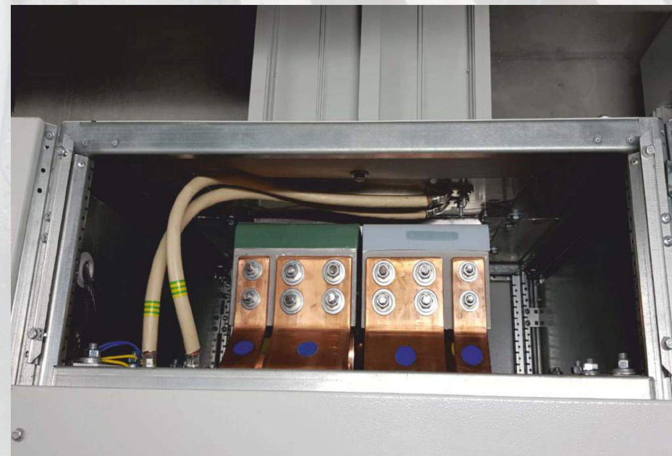
ТРК «КОСМОС», г. Челябинск Магистральный шинопровод 2500А
